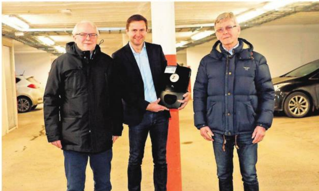
I GARASJEN: I garasjenlegget her under blokkene i Granittvegen borettslag skal det monteres 210 ladepunkter hvor man kan sette opp Zaptech-bokser. I tillegg kommer det også 64 utendørs laderpunkter. Fra venstre Svein Dalsbø, Sverre Benjaminsen og Bjørn Vestgøte.
